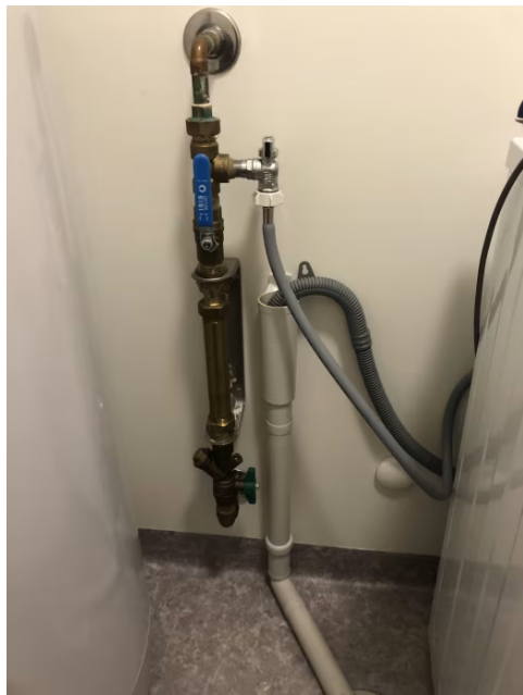
Det er opplegg for vaskemaskin på vaskerom
