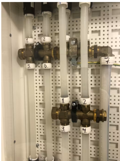
Vannfordelerskap er plassert på vaskerom
