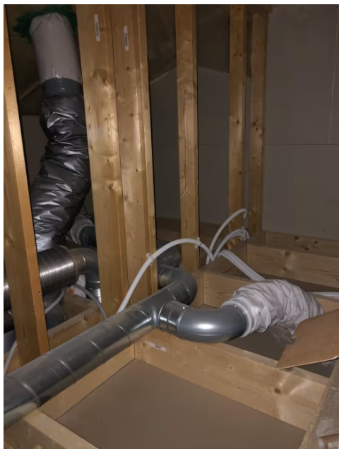
Det er innredet krypeloft med adkomst via loftsluke med stige. Her er det tekniske føringer.
