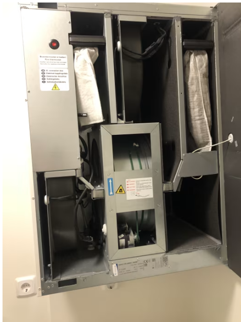
Boligen har balansert ventilasjonsanlegg
