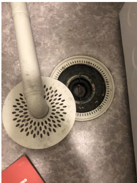
Det er vinylbelegg tilsluttet plastsluk på vaskerom.
