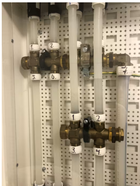
Vannfordelerskap er plassert i vaskerom
