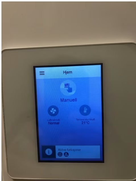
Boligen har balansert ventilasjonsanlegg
