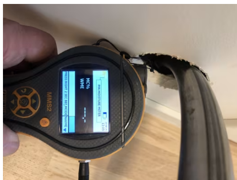
Det er foretatt fuktmåling i vegg mellom bad og gangen.
