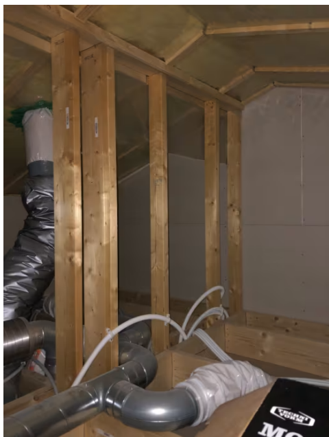
Det er innredet krypeloft med adkomst via loftsluke med stige. Her er det tekniske føringer.
