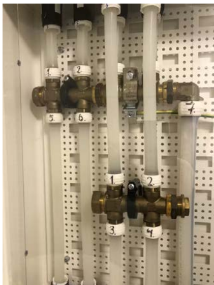
Vannfordelerskap er plassert i vaskerom
