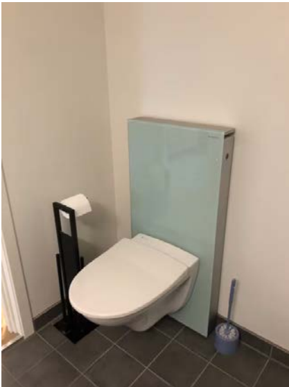
Det er vegghengt toalett.
