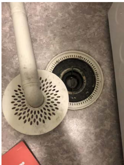
Det er vinylbelegg tilsattet plastsluk på vaskerom.
