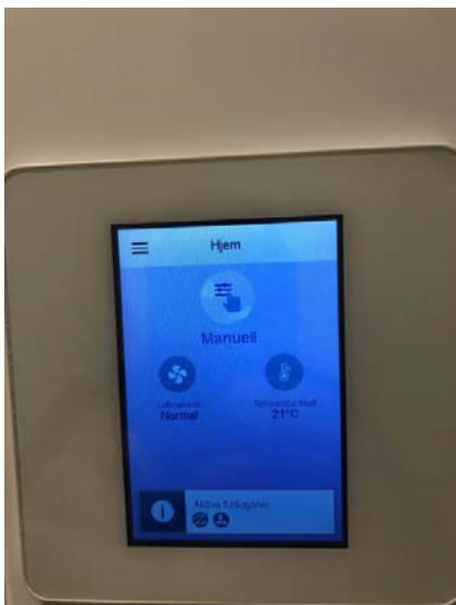
Boligen har balansert ventilasjonsanlegg
