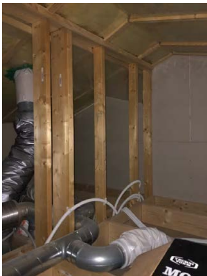
Det er uinnredet krypeloft med adkomst via lofts Luke med stige. Her er det tekniske føringer.
