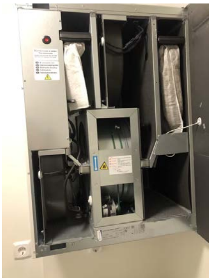
Boligen har balansert ventilasjonsanlegg
