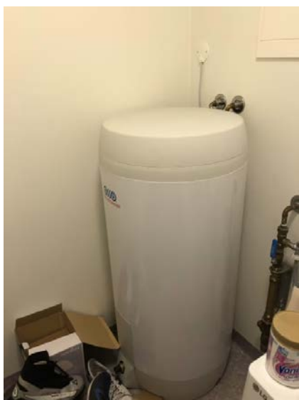
Varmtvannsbereder er på 200 liter og står på vaskerom
