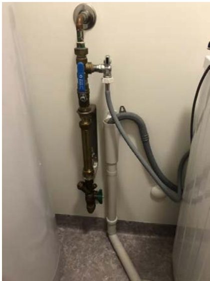
Det er opplegg for vaskemaskin på vaskerom
