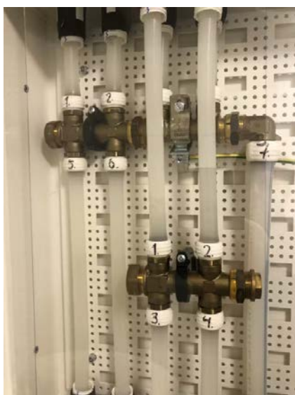
Vannfordelerskap er plassert på vaskerom
