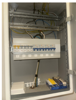
Sikringsskap med automatsikringer.
