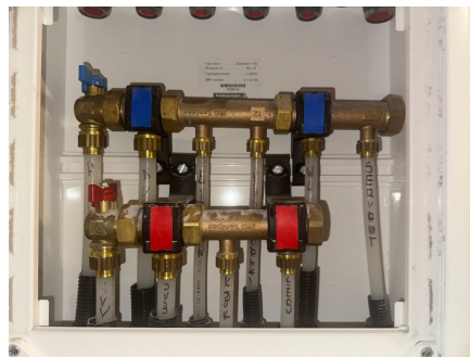
Samleskap med rørkurser og stoppekraner
