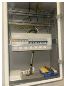
Sikringsskap med automatsikringer.
