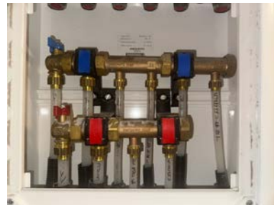
Samleskap med rørkurser og stoppekraner
