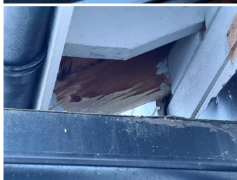
Overgang vegg/ mot flat taktekke Beslag er lagt utenpå kledning.
