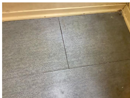
Løse skjøter i gulvbelegg.
