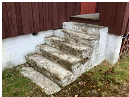
Trapp til treterrassen mangler rekkverk.
