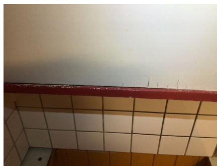
Eksempel på slitasje.
