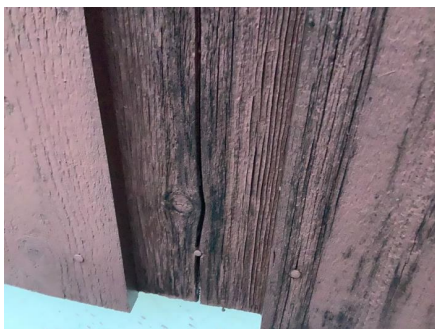
Oppsprukket, værslitt bordkledning med sverting.
