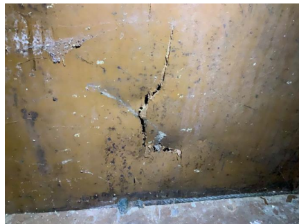
Innvendig skade på råteskadet dør.
