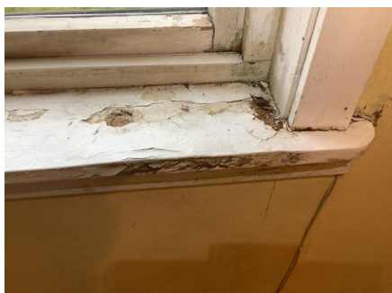
Fuktskadet omramming rundt vindu.
