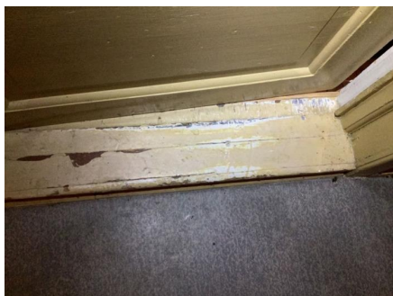
Eksempel på dør med slitasje.
