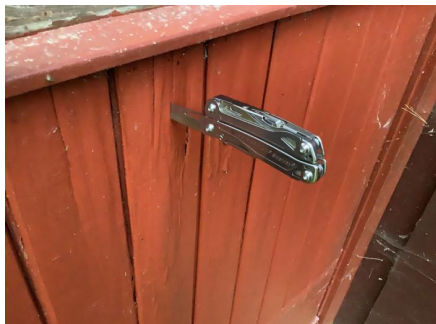
Råteskadet dør til bad.
