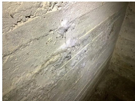
Saltutslag på grunnmur.
