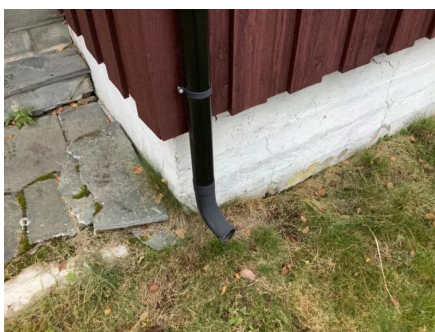
Mangelfull bortledning av takvann.
