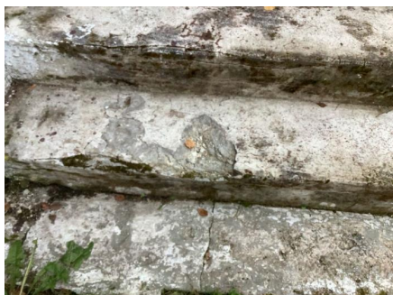
Skader i trinn i støpt trapp.
