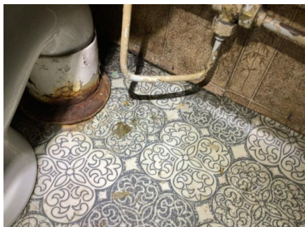
Lekkasje fra rør til toalett.
