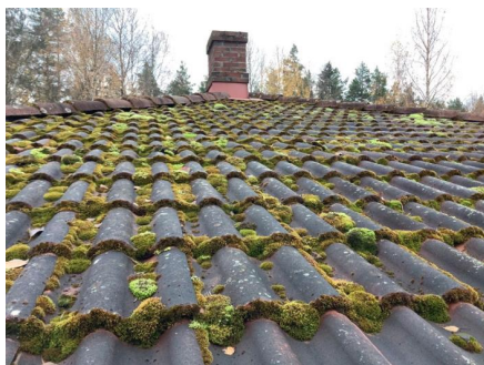
Mosedannelse på taktekkning.
