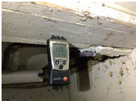
Det måles skadelig fuktinnhold i gulvbjelke.
