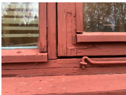
Eksempel på værslitt vindu med sprekker i karm.
