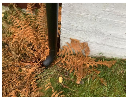
Mangelfull bortledning av takvann.
