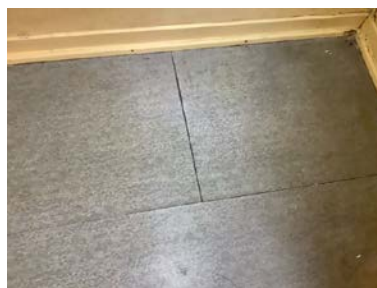
Løse skjøter i gulvbelegg.
