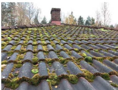
Mosedannelse på taktekkning.
