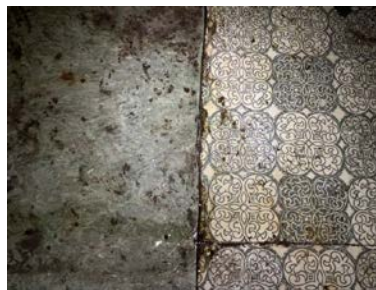
Utette skjøter i vinylbelegg.
