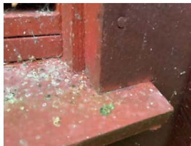
Omranning rundt vindu er ført helt ned til vannbrett.
