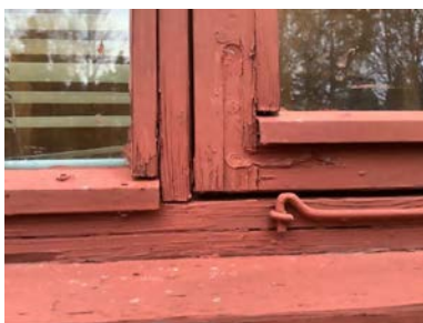
Eksempel på værslitt vindu med sprekker i karm.
