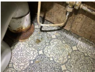
Lekkasje fra rør til toalett.
