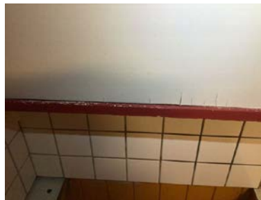
Eksempel på slitasje.
