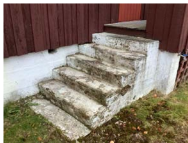
Trapp til treterrassen mangler rekkverk.
