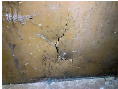
Innvendig skade på råteskadet dør.
