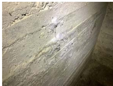
Saltutslag på grunnmur.
