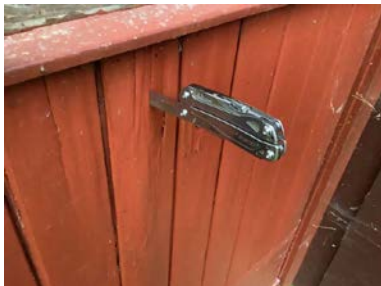
Råteskadet dør til bad.
