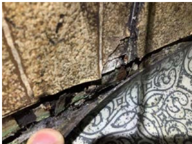
Tegn til fuktskader i vegg mot stue.
