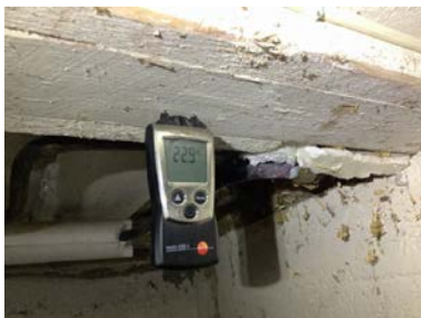
Det måles skadelig fuktinnhold i gulvbjelke.
