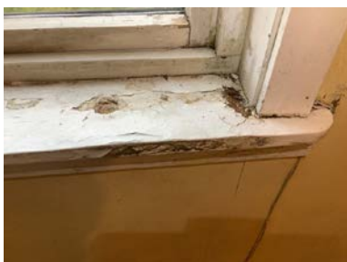
Fuktskadet omramming rundt vindu.
