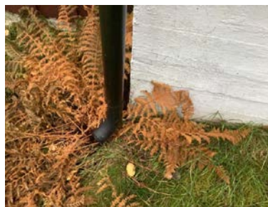
Mangelfull bortledning av takvann.
