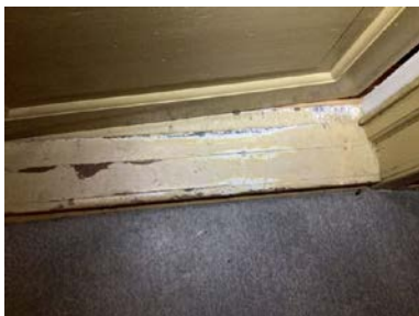
Eksempel på dør med slitasje.
