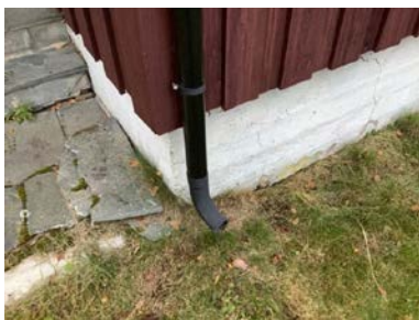
Mangelfull bortledning av takvann.
