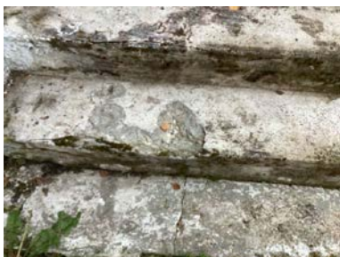
Skader i trinn i støpt trapp.
