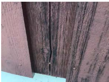
Oppsprukket, værslitt bordkledning med sverting.
