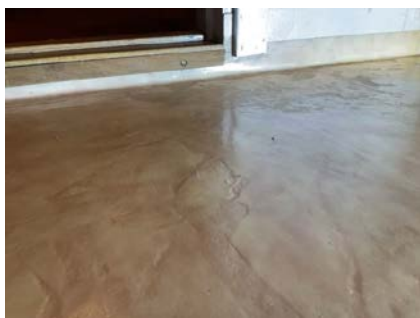
Oppkant på belegget ved døren.
