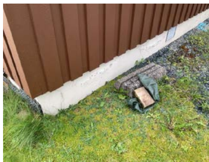
Deler av grunnmur har synlig grunnmursplast.
