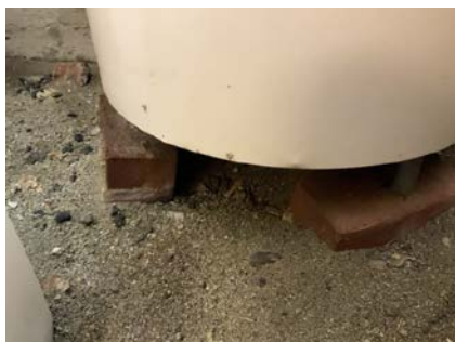
Varmvannsbereider står på murstein.
