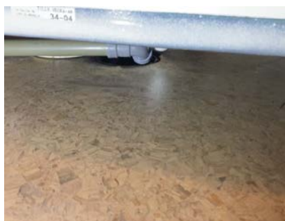
Sluk under dusjkabinett.
