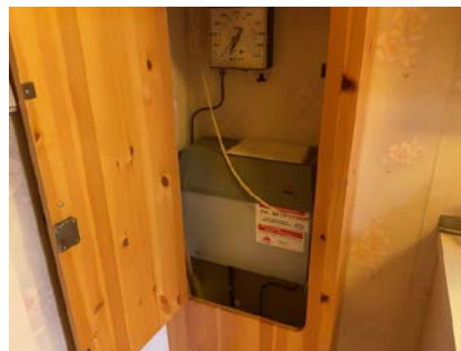
Dagtank i skap på bad.
