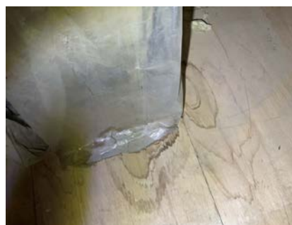
Fuktskjolder på gulv ved pipe.
