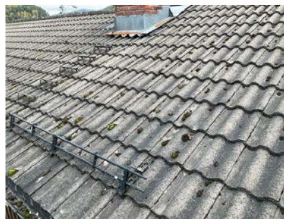
Taktekke med aldersslitasje og mose.
