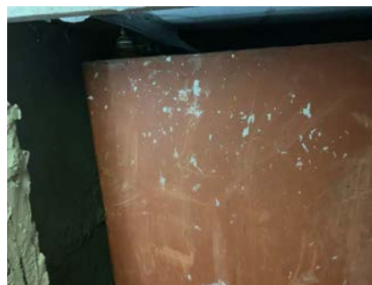
Ståltank i krypkjelleren.
