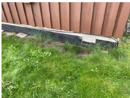
Grunnmursplast er ikke tilpasset terreng og mangler topplst.
