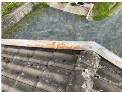
Rust på beslag på vindskier.
