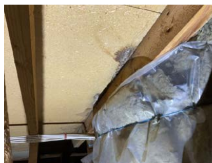
Misfarging på undertak ved pipe.
