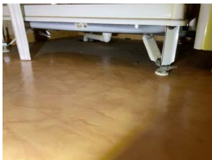
Sluk under dusjkabinett.
