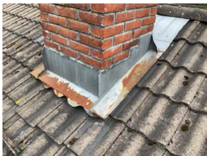
Rust på pipebeslag.
