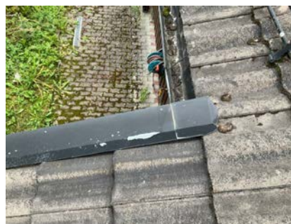
Flassing i overflatebehandling på beslag/takrenner.
