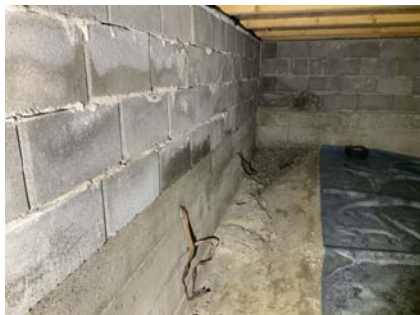
Fukt på innvendig grunnmur.
