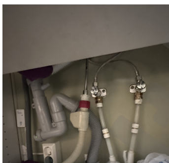
Røropplegg i kjøkkenbenk med Waterguard
