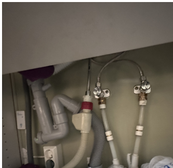
Røropplegg i kjøkkenbenk med Waterguard
