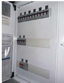
Sikringskap med automatsikringer.
