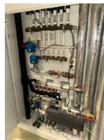
Samleskap med rørkurser og stoppekraner
