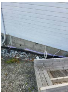
Kabler må festes / ferdigstilles.
