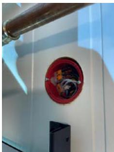
Åpen koblingsboks, mangler lokk.
