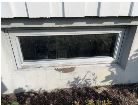
riss/sprekker i puss utvendig på grunnmur.
