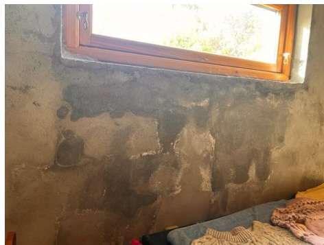
Saltutslag i grunnmur.
