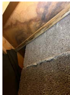
Fuktmerke på oppside av pipe..
