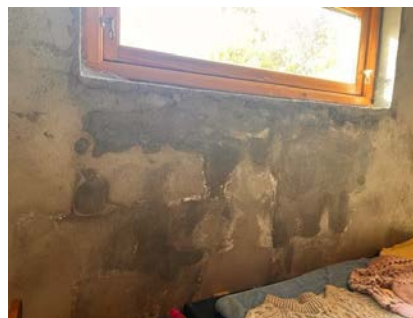
Saltutslag i grunnmur.
