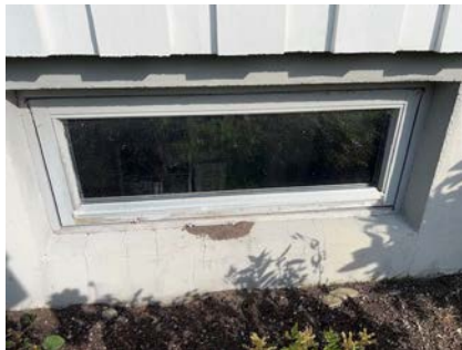
riss/sprekker i puss utvendig på grunnmur.
