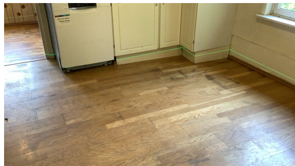
Godt synlige skjevheter på kjøkken
