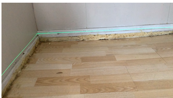
Gulvet har synket og det er synlig fugeskum mellom vegg og gulv.
