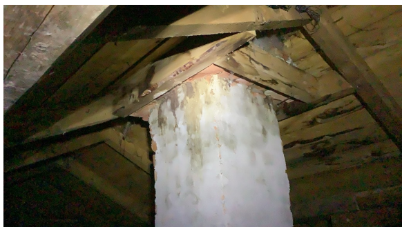
Rennemerker rundt pipe. Merkene var tørre på befaringen.
