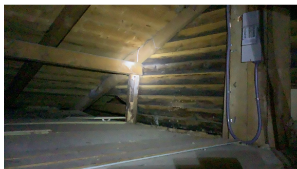
Misfarging etter kondens.
