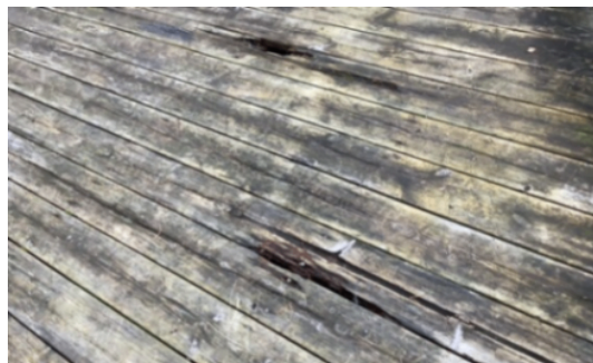
Råteskader i terrassegulv på begge.
