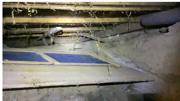
Synlige deler av krypkjeller oppfattes tørr. Det ble ikke målt unormale verdier i trever.
