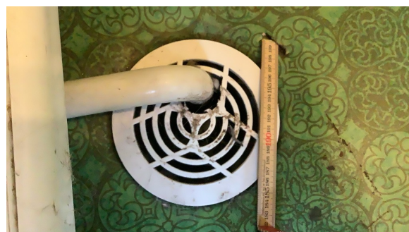
Hull i belegg ved sluk.
