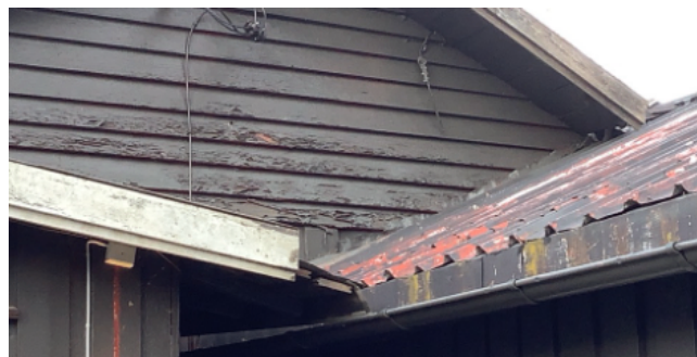
Vedlikeholdsbehov av utvendig kledning.
