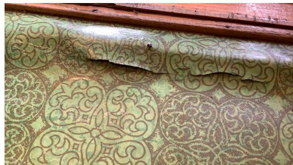
Membran på gulv og vegger er ikke tett.
