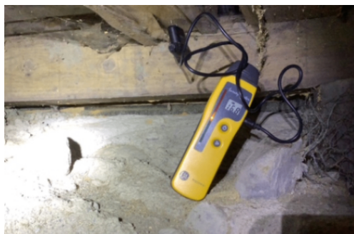
Det ble målt grenseverdi for fukt i gulvbjelke.
