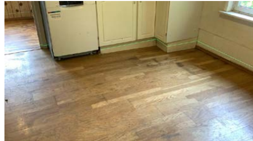
Godt synlige skjevheter på kjøkken
