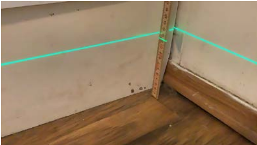
90 mm høydeforskjell i påbygg.
