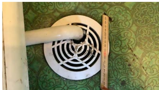
Hull i belegg ved sluk.
