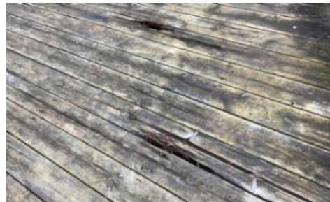
Råteskader i terrassegulv på begge.
