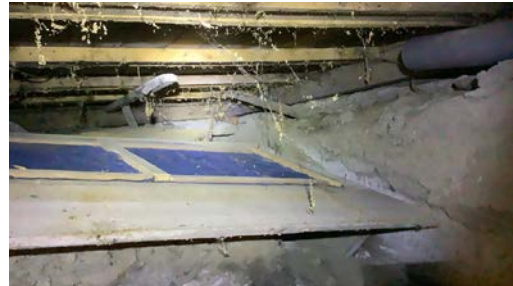
Synlige deler av krypkjeller oppfattes tørr. Det ble ikke målt unormale verdier i trever.
