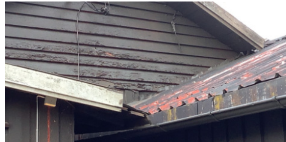
Vedlikeholdsbehov av utvendig kledning.
