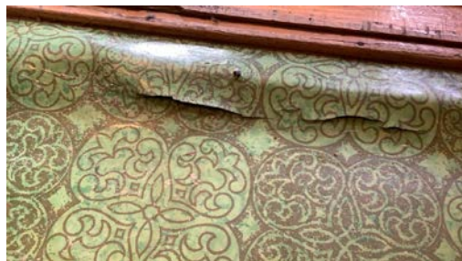
Membran på gulv og vegger er ikke tett.
