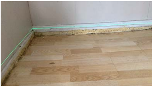
Gulvet har synket og det er synlig fugesum mellom vegg og gulv.
