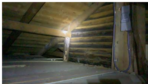
Misfarging etter kondens.
