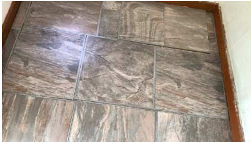
Laminat har slippet i sammenføyninger.
