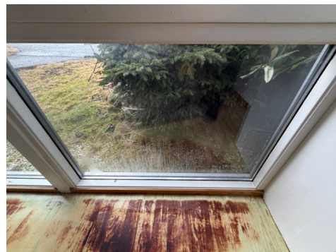
Punktert vindu i stue
