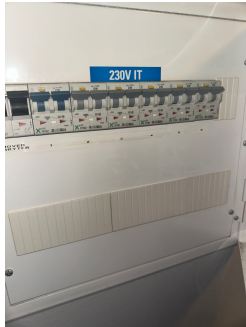
Sikringsskap med automatsikringer.
