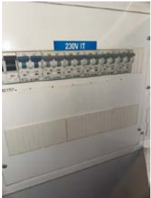
Sikringsskap med automatsikringer.
