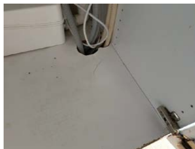
Svelleskade på bunnplate.
