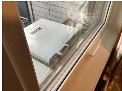
Vindu med merke/ripe.
