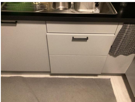
Hindring i å lukke underskap.
