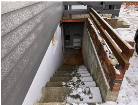
Håndløper mangler på begge sider i kjellertrapp
