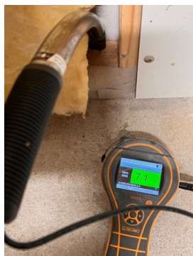
Fuktmåling i påforet betongvegg mot terreng
