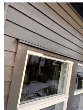
Symptomer på råteskader over vinduer.
