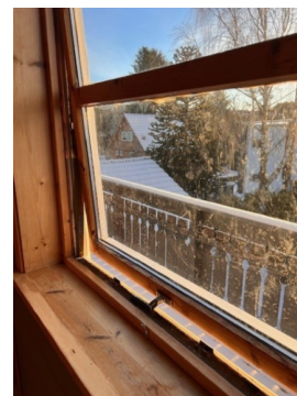
Defekt låsefunksjon i vindi 2 etg.
