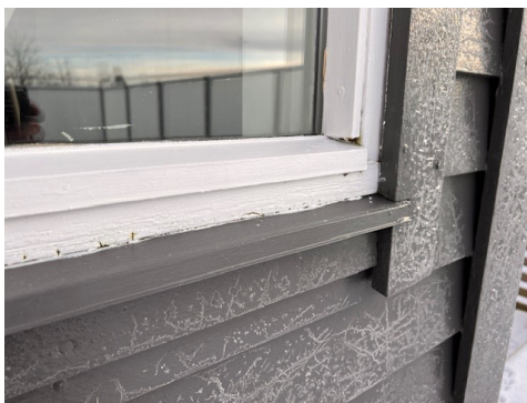
Slitasje i vinduer.
