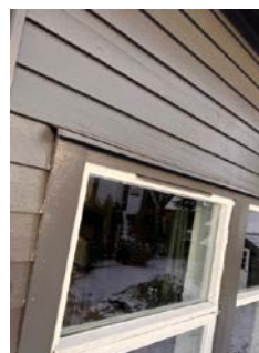
Symptomer på råteskader over vinduer.
