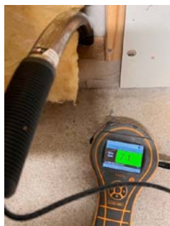
Fuktmåling i påføret betongvegg mot terreng
