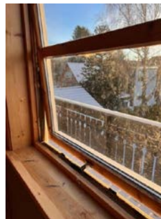
Defekt låsefunksjon i vindi 2 etg.
