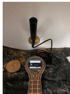
Fuktmåling i vegg mot våtsone
