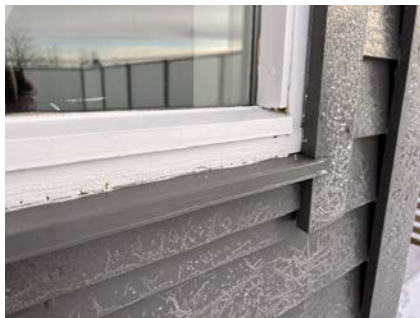
Slitasje i vinduer.
