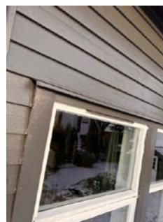
Symptomer på råteskader over vinduer.
