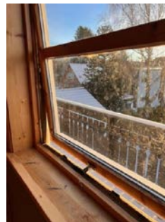
Defekt låsefunksjon i vindi 2 etg.
