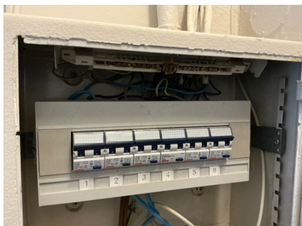
Automatsikringer i sikringsskap plassert ientré.
