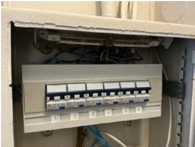
Automatsikringer i sikringsskap plassert ientré.
