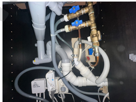
Røropplegg i kjøkkenbenk med Waterguard
