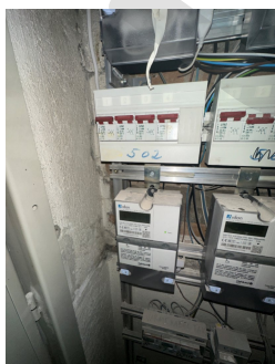
Sikringsskap med automatsikringer.
