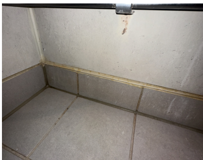
Silikon mellom baderomsplate og flis
