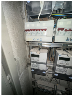
Sikringsskap med automatsikringer.
