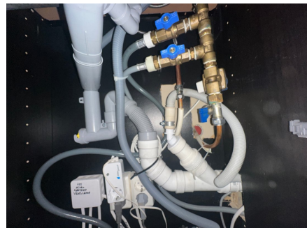
Rørøpplagg i kjøkkenbenk med Waterguard
