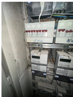
Sikringsskap med automatsikringer.
