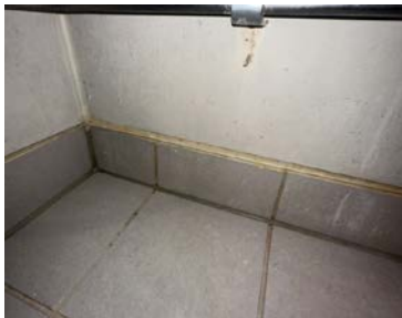
Silikon mellom baderomsplate og flis
