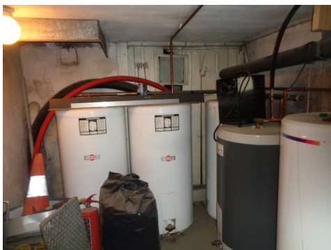
Varmtvannsberedere i kjeller.
