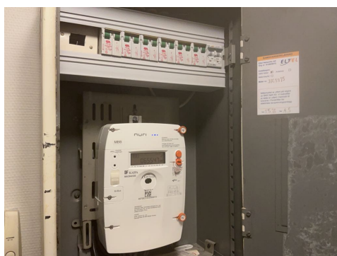
Sikringsskap i entré.
