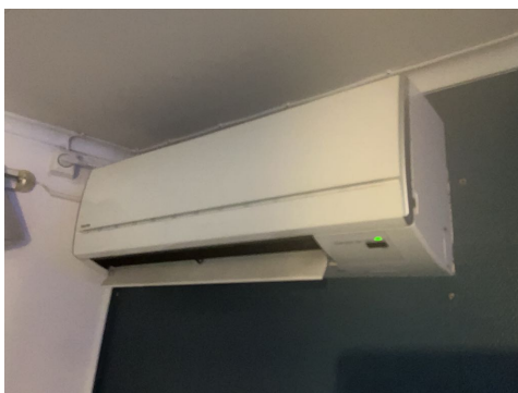
Varmepumpe i stue.
