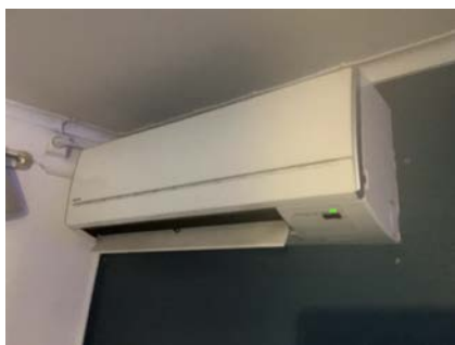
Varmepumpe i stue.
