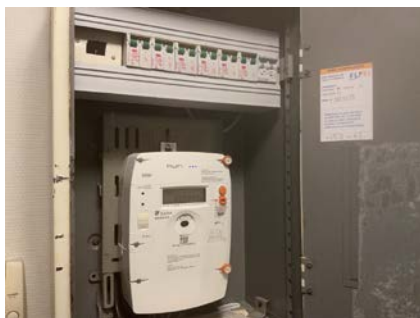
Sikringsskap i entré.
