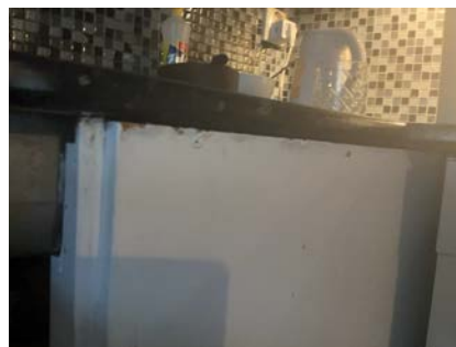
Skader på fronter.
