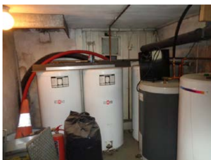
Varmtvannsberedere i kjeller.
