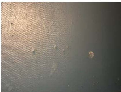
Noe hull og skader på noen vegget.
