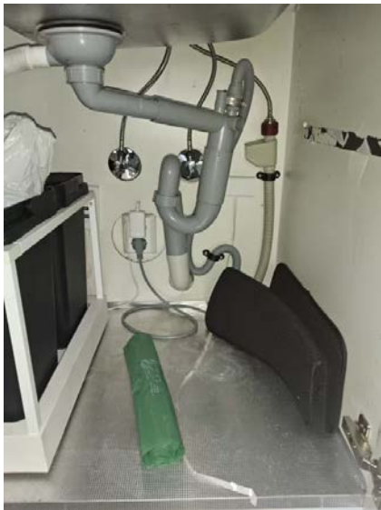
Bilde viser røropplegg under oppvaskkum på kjøkken.
