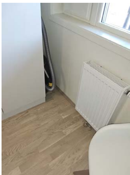
Bilde viser radiator på soverom.
