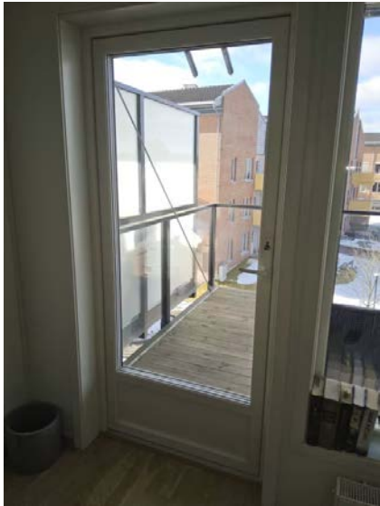
Bilde viser balkongdør.
