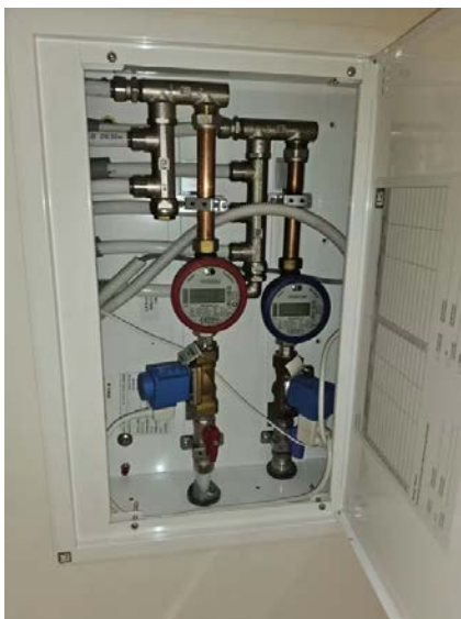
Bilde viser fordelerskap for rør i rørsystem.
