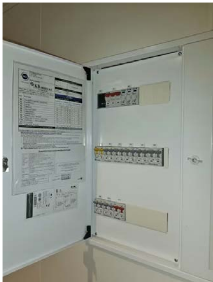
Bilde viser sikringsskap.
