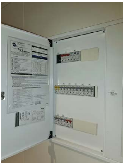
Bilde viser sikringsskap.
