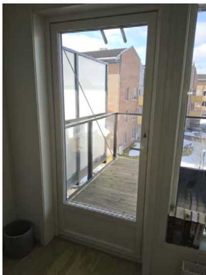
Bilde viser balkongdør.
