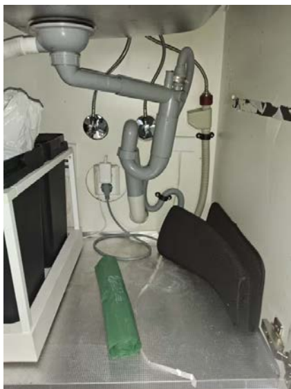
Bilde viser røropplegg under oppvaskkum på kjøkken.
