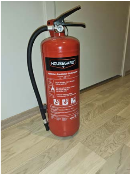
Bilde viser brannslukningsapparat.
