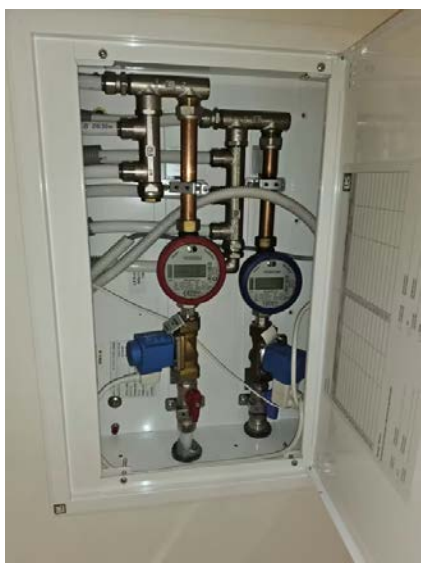
Bilde viser fordelserskap for rør i rørsystem.
