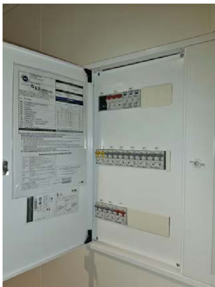
Bilde viser sikringsskap.
