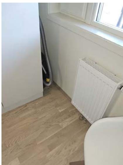
Bilde viser radiator på soverom.
