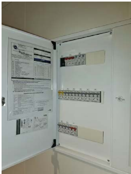
Bilde viser sikringsskap.
