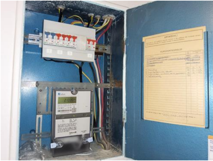
Beskrivelse - [Sikringskap med kursfortegnelse.]
