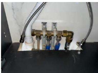
Vannfordelerstokk på bad/wc
