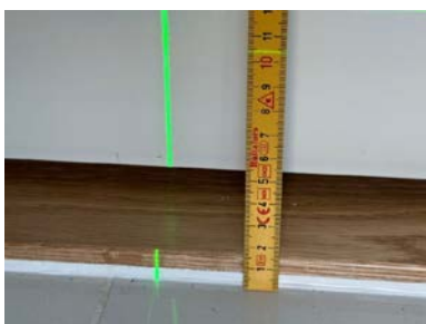
Fallforhold ca. 104 mm overkant gulv ved terskel
