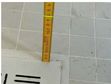
Fallforhold ca. 119 mm topp slukrist i dusjsone
