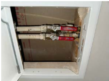
Inspeksjonslukke med eldre kobberør samt stoppekraner.
