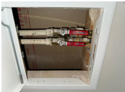
Inspeksjonslukke med eldre kobberør samt stoppekraner.
