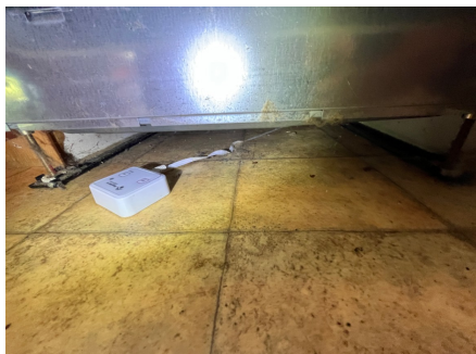
Vannstoppesystem under oppvaskmaskin.
