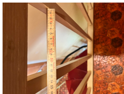
Store åpninger i rekkverk rundt trappeåpning.
