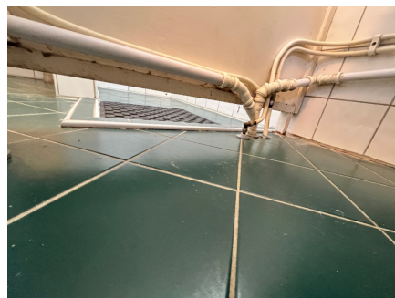
Sprekk i fuger i våtsone.
