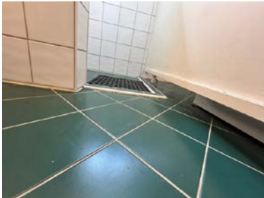
Forhøyning ved dusjnise.
