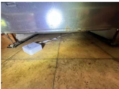
Vannstoppesystem under oppvaskmaskin.
