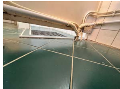
Sprekk i fuge i våtsone.
