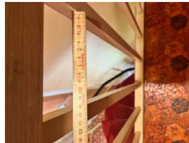
Store åpninger i rekkverk rundt trappeåpning.
