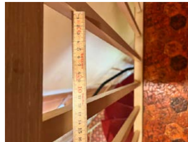
Store åpninger i rekkverk rundt trappeåpning.
