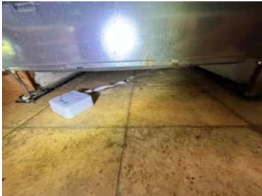
Vannstoppesystem under oppvaskmaskin.
