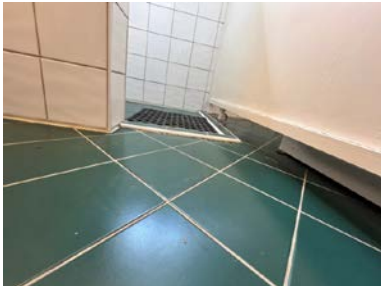
Forhøyning ved dusjnise.
