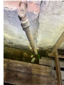
Eldre malmrør som trolig ikke er i bruk.
