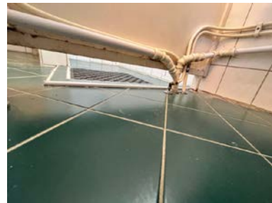
Sprekk i fuge i våtsone.
