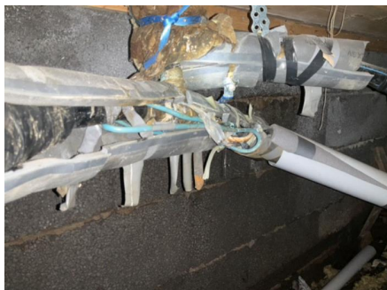
Lekkasje synlig på vanninntak i krypkjeller på befaringdagen.
