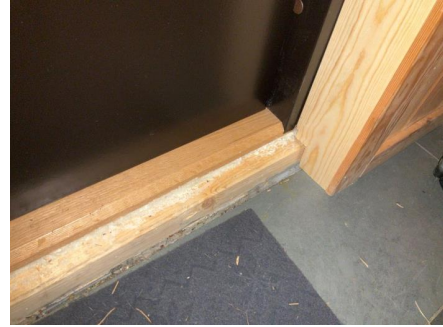
Manglende feielist/innlisting av dørterskel på ytterdør.
