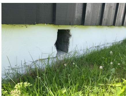
Manglende ventilrist i grunnmur.
