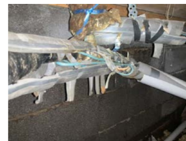
Lekkasje synlig på vanninntak i krypkjeller på befaringsdagen.
