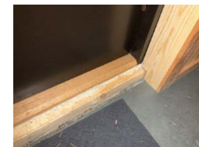
Manglende feielist/innlisting av dørterskel på ytterdør.
