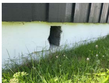
Manglende ventilrist i grunnmur.
