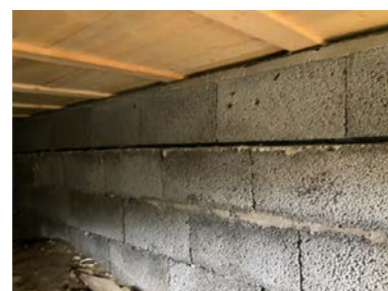
Horisontal sprekk under øverste skift på lettklinkerblokker.
