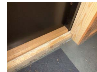
Manglende feielist/innlisting av dørterskel på ytterdør.
