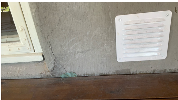
Mindre sprekkdannelser i grunnmur.
