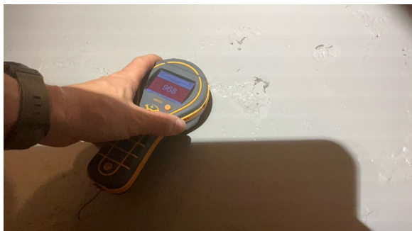
Saltutslag på betonggulv, enkle fuktsøk viste forhøyde verdier.
