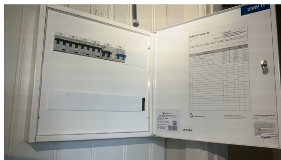
Sikringsskap i kjeller. En kurs er ikke beskrevet i kursbetegnelsen.
