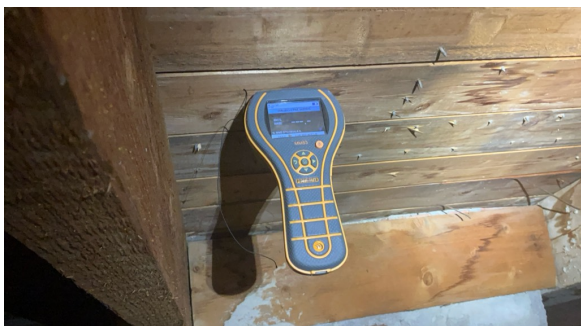
Fuktmerker flere steder. Enkle fuktmålinger viste tørre verdier.
