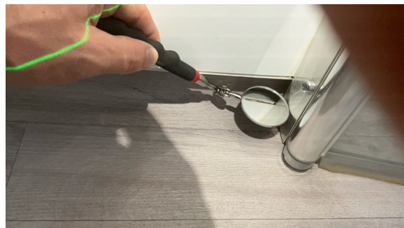
Utett overgang mellom sokkelskinne og baderomspanel i dusjsone. Dette øker risikoen for fuktinntregning. Fuger må utbedres.
