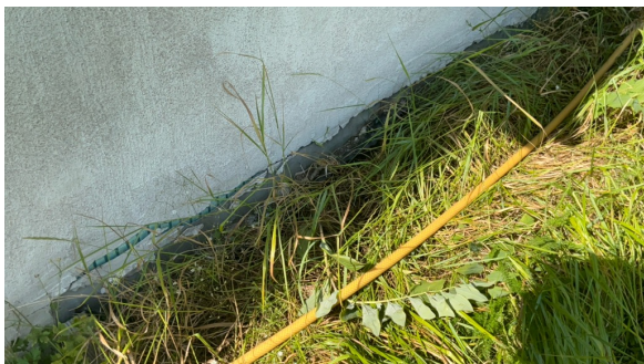
Manglende avslutningslist på utvendig grunnmurplast.
