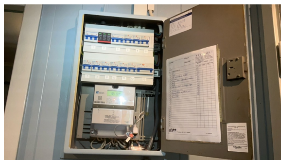
Sikringsskap i gang 1. etasje. Utette gjennomføringer.
