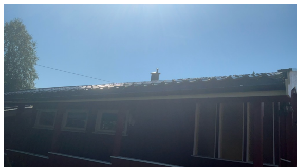
Skjevheter/ujevnheter på takflate.
