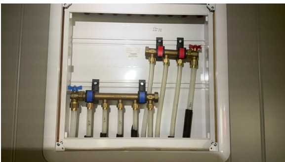
Fordelerskap i 1. etasje.
