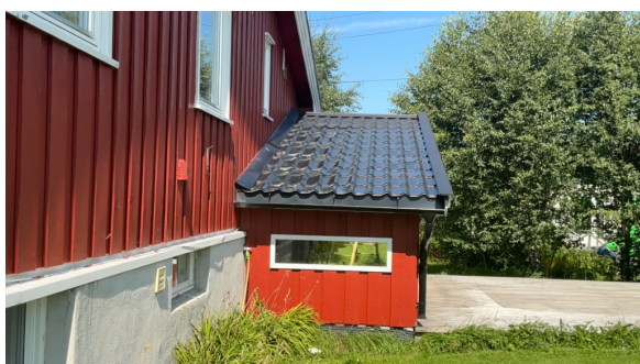
Deformerte takplater over takoverbygd inngangsparti.
