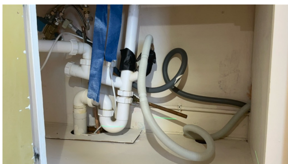
Ufagmessig/provisorisk utførelse i kjøkkenbenk.
