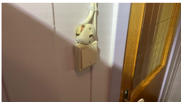
Enkelte synlige avvik på det elektriske anlegget.
