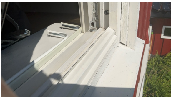
Vinduer bærer preg av slitasje.
