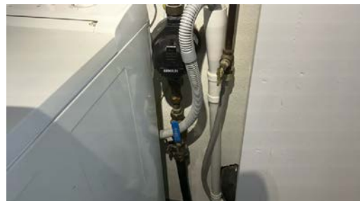
Stoppekran og vannmåler i bad 1. etasje.
