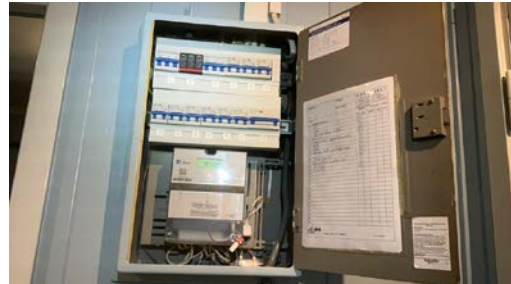
Sikringsskap i gang 1. etasje. Utette gjennomføringer.
