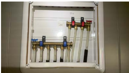
Fordelerskap i 1. etasje.
