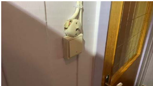
Enkelte synlige avvik på det elektriske anlegget.
