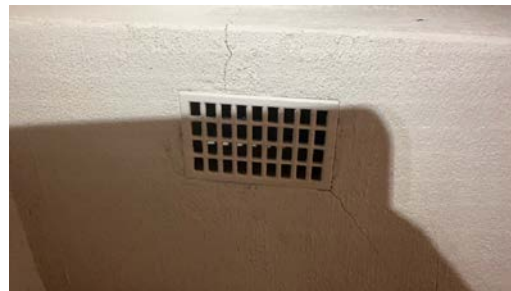
Sprekker i peis.
