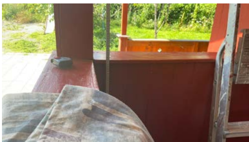
Lavt rekkverk på deler av konstruksjonen.
