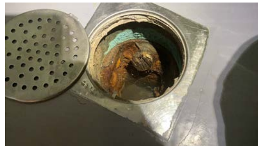
Kontroll av sluk. Rust i sluk registrert. Manglende membran på gulv og klemring i sluk.
