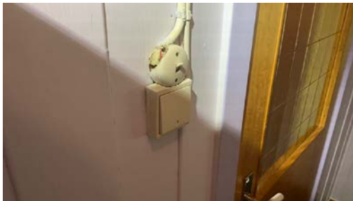
Enkelte synlige avvik på det elektriske anlegget.
