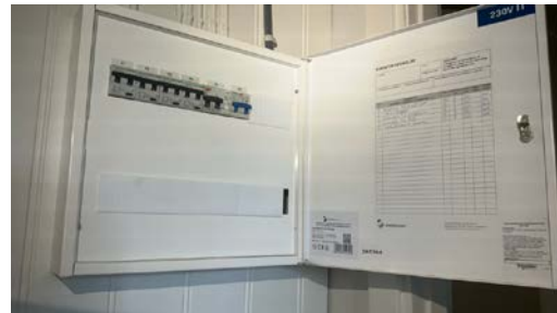
Sikringsskap i kjeller. En kurs er ikke beskrevet i kursbetegnelsen.
