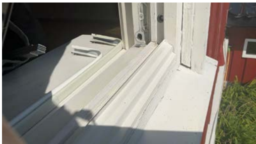
Vinduer bærer preg av slitasje.
