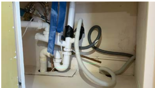
Ufagmessig/provisorisk utførelse i kjøkkenbenk.
