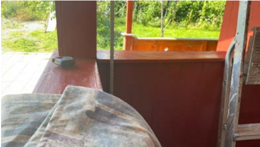
Lavt rekkverk på deler av konstruksjonen.
