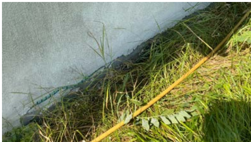
Manglende avslutningslist på utvendig grunnmursplast.
