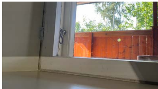
Sprukket kjellervindu registrert.
