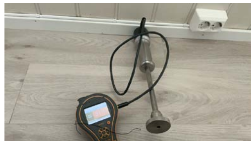
Fuktmåling med hammerelektrode i vegg mot terreng viste skadelige verdier for fukt. Måling ble utført i stue/kjøkken og soverom.
