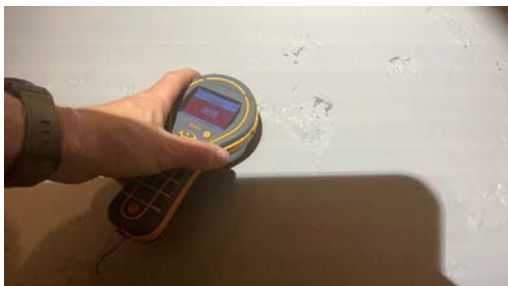
Saltutslag på betonggulv, enkle fuksøk viste førhøyde verdier.
