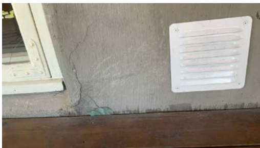
Mindre sprekkdannelser i grunnmur.
