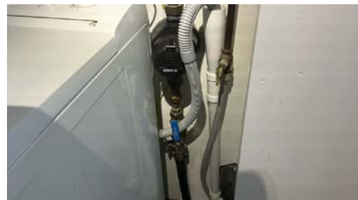
Stoppekran og vannmåler i bad 1. etasje.
