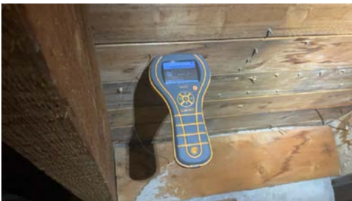
Fuktmerker flere steder. Enkle fuktmålinger viste tørre verdier.
