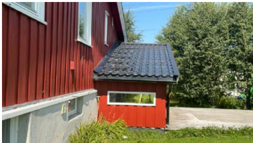
Deformerte takplater over takoverbygd inngangsparti.
