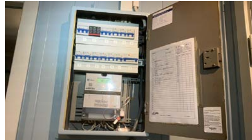
Sikringsskap i gang 1. etasje. Utette gjennomføringer.
