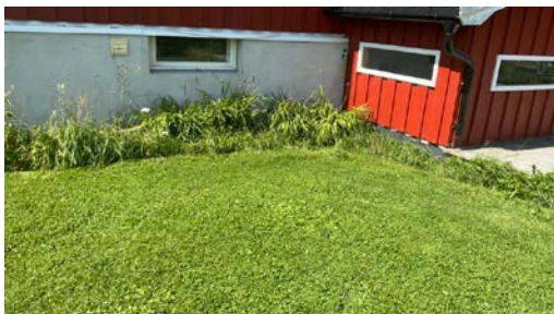
Delvis fall på terreng mot grunnmur. Forholdet gis tilstandsgrad 3 i henhold til NS 3600.
