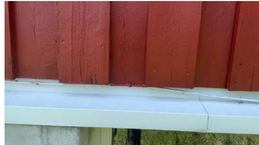
Deler av kledning bærer preg av slitsje.
