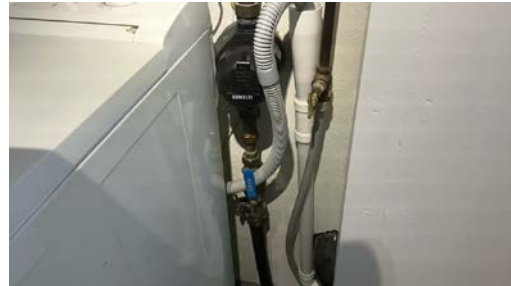
Stoppekran og vannmåler i bad 1. etasje.
