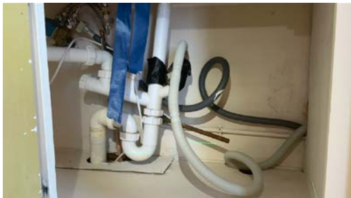
Ufagmessig/provisorisk utførelse i kjøkkenbenk.
