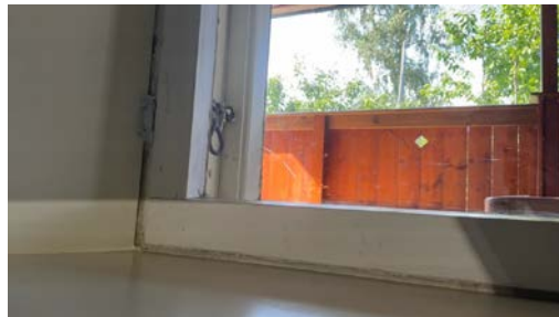
Sprukket kjellervindu registrert.
