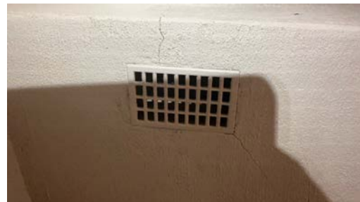
Sprekker i peis.
