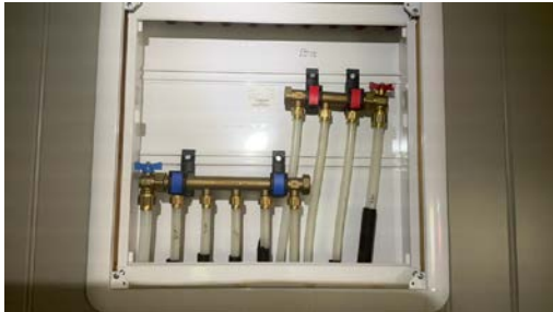
Fordelerskap i 1. etasje.
