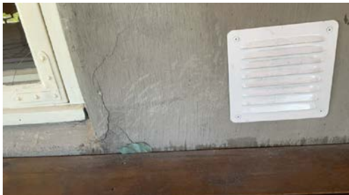
Mindre sprekkdannelser i grunnmur.
