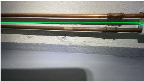
Avskalling og saltutslag på vegg.
