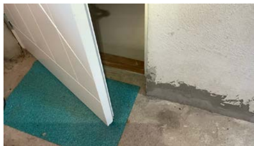
Kjellerdør trenger justering.
