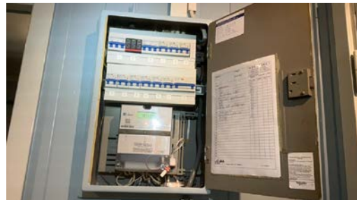
Sikringsskap i gang 1. etasje.
