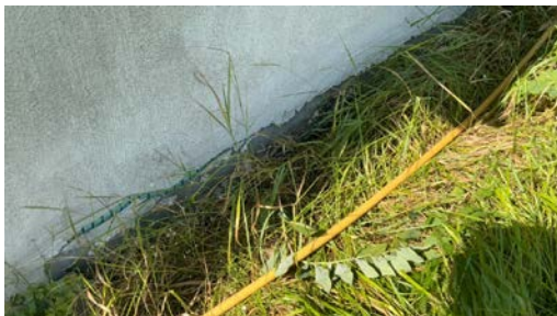
Manglende avslutningslist på utvendig grunnmursplast.
