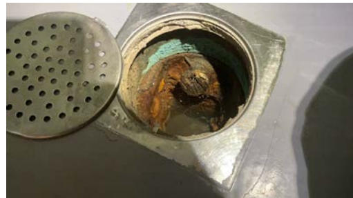
Kontroll av sluk. Rust i sluk registrert. Manglende membran på gulv og klemring i sluk.
