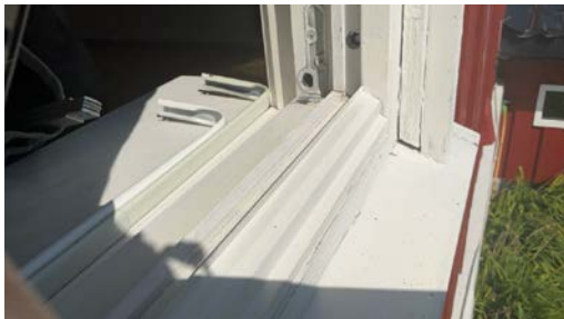
Vinduer bærer preg av slitasje.
