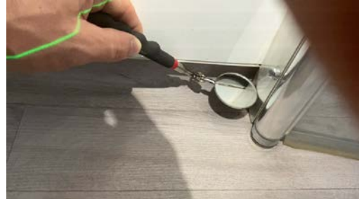
Utett overgang mellom sokkelskinne og baderomspanel i dusjsone. Dette øker risikoen for fuktinntregning. Fuger må utbedres.
