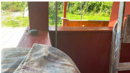
Lavt rekkverk på deler av konstruksjonen.
