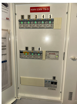
Sikringsskap med automatsikringer.
