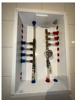
Samleskap med rørkurser og stoppekraner
