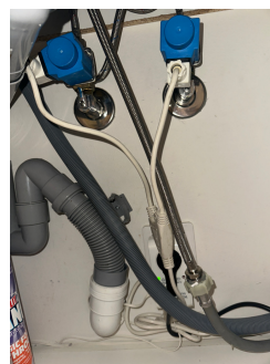
Røropplegg i kjøkkenbenk med Waterguard
